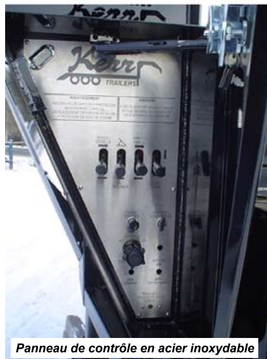
Unité de puissance
